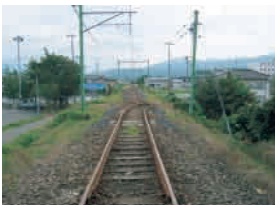
湾曲した線路（新潟県中越沖地震）
