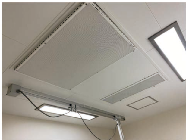
図 16：クリーンファンユニットフィルター
